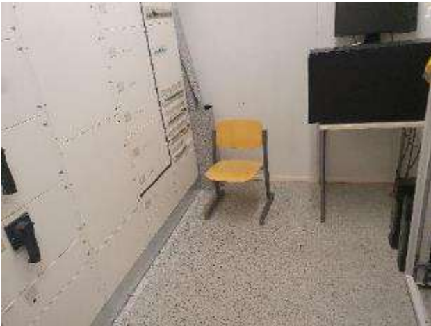
KUVA 75 2003 RAKENNETTU UUSI SÄHKÖPÄÄKESKUS.
