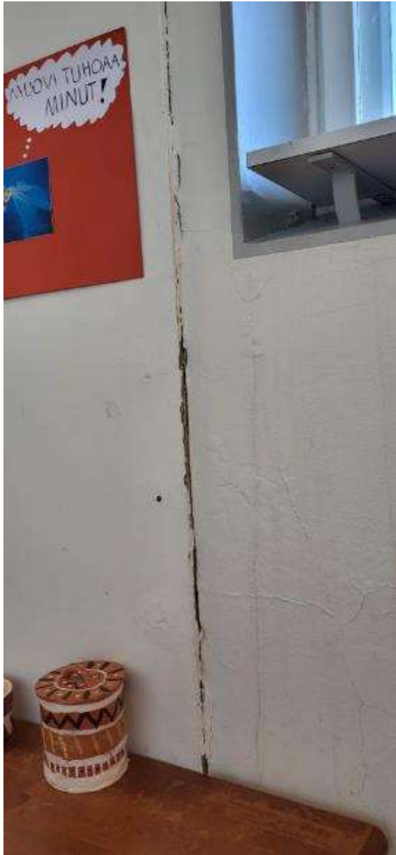
KUVA 69 VANHAN JA UUDEN OSAN RAJAPINNASTA VUOTANUT VETTÄ SISÄLLE.
