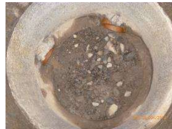
KUVA 89 POHJATON SADEVESIEN KOKOOMAKAIVO.
