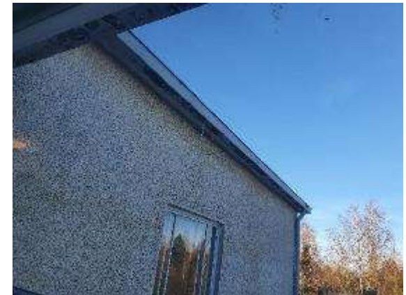
KUVA 95 SADEVESIKOURUT VUOTAVAT USEASTA KOHDASTA.
