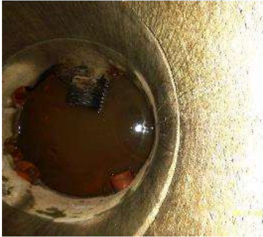
KUVA 90 KOKOOMAKAIVOSSA OLEVAT PUTKET OSITTAIN VEDENPINNAN ALAPUOLELLA.
