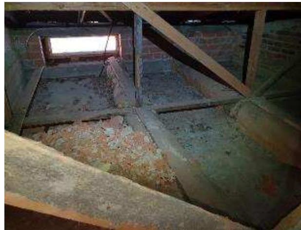
KUVA 46 YLÄPOHJAN PALOPERMANTO BETONIA.
