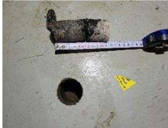
KUVA 110 ALAPOHJARAKENTEESSA VOIMAKAS PAH-YHDISTEIDEN HAJU.
