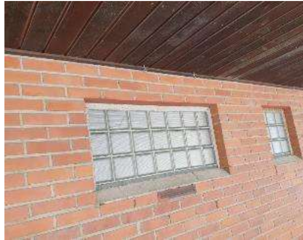
KUVA 45 WC- TILOJEN IKKUNAT OVAT LASITIILTÄ
