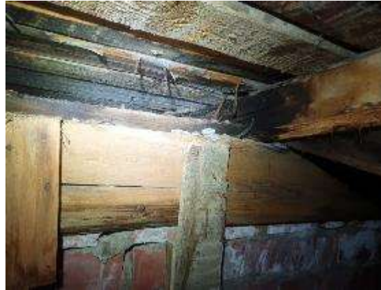
KUVA 98 VESIKATTO VUOTAA PORRASHUONEEN 311 KOHDALTA.
