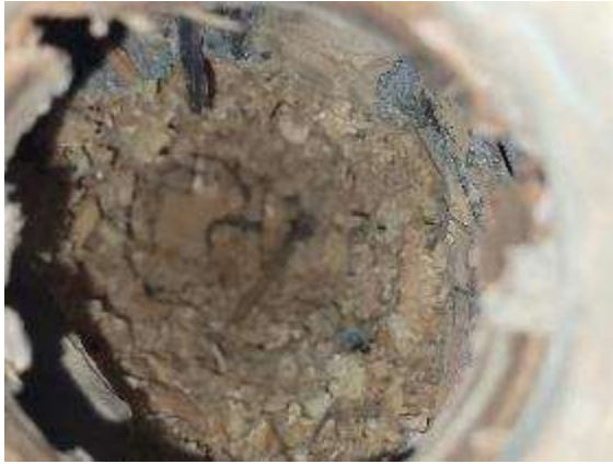
KUVA 114 VÄLIPOHJASSA OLEVA KUTTERINLASTU TUMMUNUTTA JA RAKENTEESTA SELKEÄ MIKROBIPERÄINEN HAJU.
