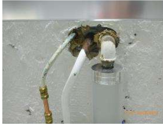
KUVA 104 TIIVISTÄMÄTÖN PUTKILÄPIVIENTI. KUPARIPUTKI VUOTANUT JA KORJATTU UUDELLA PUTKELLA.
