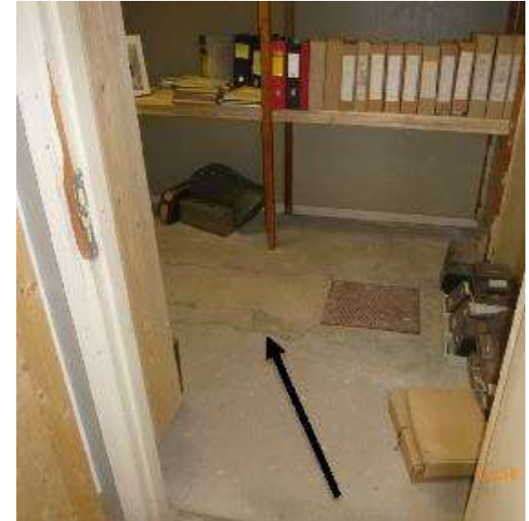
KUVA 100 ALAKERRAN ARKISTOTILASSA 010 ON KOSTEUTTA LATTIASSA USEAN NELIÖN ALUEELLA.
