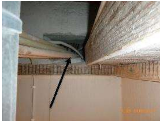
KUVA 105 ALASLASKUN YLÄPUOLELLA TIIVISTÄMÄTÖN LÄPIVIENTI.
