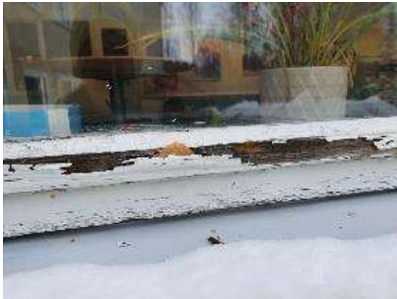
KUVA 97 OSASSA IKKUNOITA LAHOVAURIOITA.
