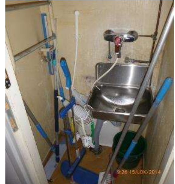
KUVA 106 PUKUHUONEKÄYTVÄN SIIVOUSKOMERO HUONOSSA KUNNOSSA.
