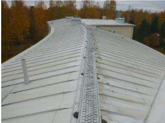
KUVA 96 VESIKATOLLE KIINNITETTY KATTOSILLAT JA LUMIESTEET VIRHEELLISESTI TEKEMÄLLÄ KATTEESEEN REIKIÄ.
