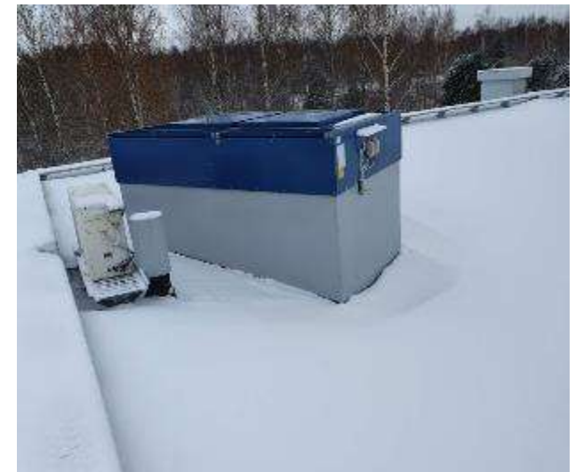
KUVA 48 KEITTIÖN JA 1. KRS:N SOSIAALITILOJEN POISTOIMUREIDEN LÄMMÖNTALTEENOTON NEULAPATTERI
