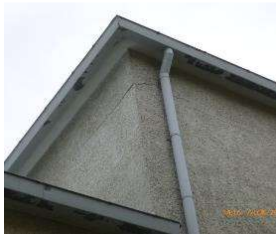
KUVA 93 VAAKAHALKEAMIA SEINIEN YLÄOSISSA.
