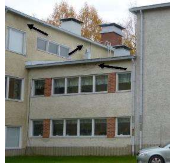
KUVA 94 VESIVUOTOJÄLKIÄ SEINIEN YLÄOSISSA.
