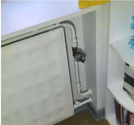
KUVA 108 PATERIVENTTIILI VUOTAA REHTORIN HUONEESSA.
