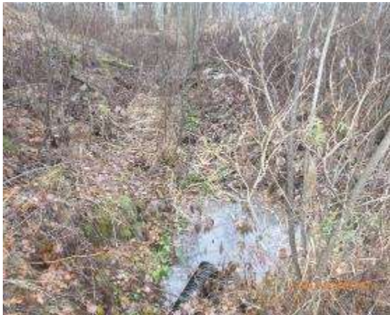
KUVA 91 PURKUPUTKEN PÄÄ OSITTAIN UMMESSA.
