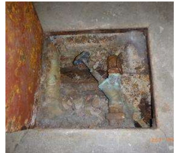
KUVA 101 ARKISTOTILAN LATTIASSA PUTKIKANAALI, JOSTA TULEE TILAAN POIKKEAVAA HAJUA.
