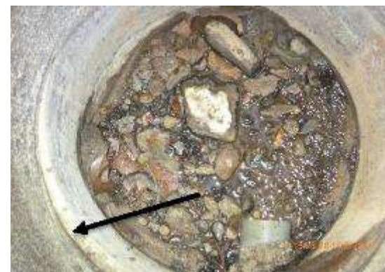
KUVA 88 BETONISET SALAOJAKAIVOT POHJATTOMIA.
