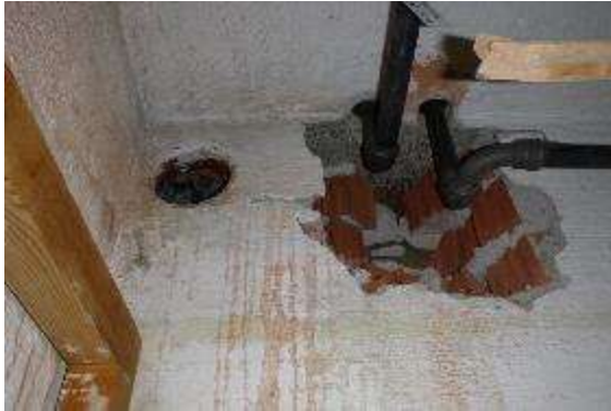
KUVA 102 TIIVISTÄMÄTÖN LÄPIVIENTI KELLARIN VARASTOSSA 008.
