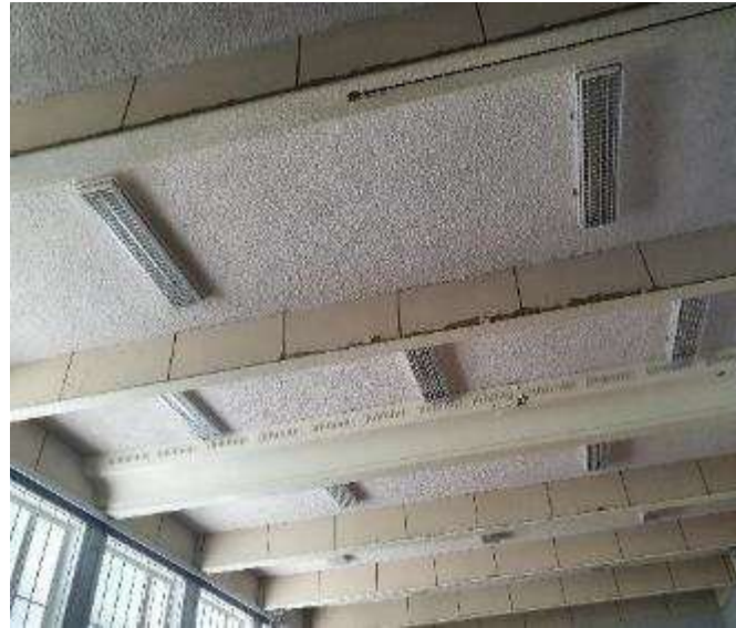
KUVA 54 VOIMISTELUSALIN LAPIO ALKUPERÄISESSÄ KUNNOSSA. AKUSTOLEVYT OVAT RIKKOONTUNEET AIKOJEN SAATOSSA.
