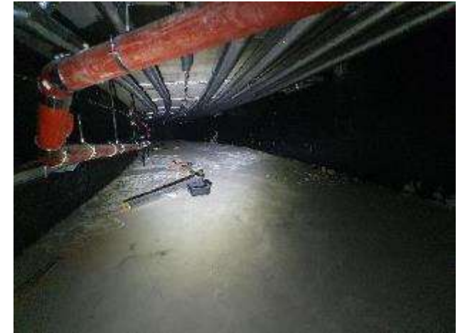
KUVA 72 KELLARIN MATALA TALOTEKNIKKAKUILU
