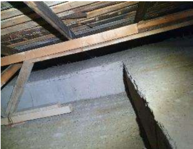
KUVA 81 LIIKUNTASALIN ILMANVAIHTOKANAVAT BETONIA
