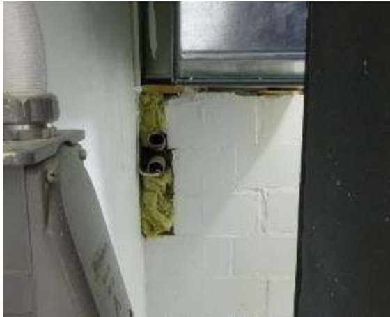
KUVA 103 TILASSA 009 IV-KONEEN LÄPIVIENTI TIIVISTETTY LASIVILLALLA.
