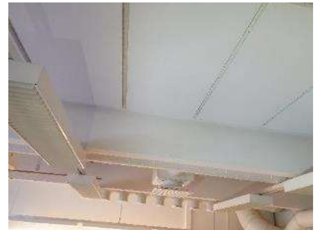
KUVA 79 ILMANVAIHDON KANAVAT JA PÄÄTE-ELIMET UUSITTU OSAAN RAKENNUSTA VUONNA 2003.
