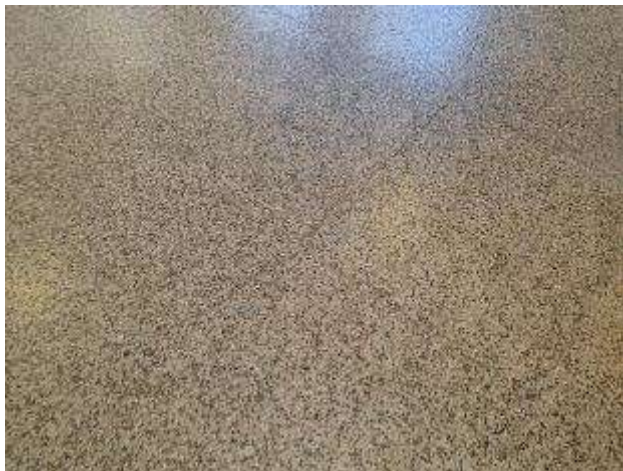
KUVA 59 PORRASAULAN MOSAIIKKIBETONILAATOISSA HALKEAMIA.
