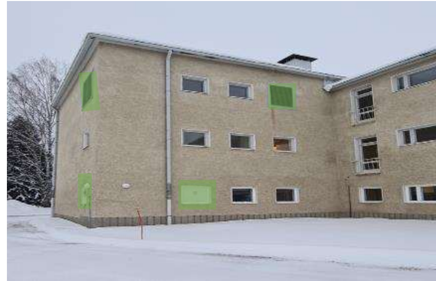
KUVA 38 ILMANVAIHDON SÄLEIKKÖJÄ TEHTY ULKOSEINÄÄN JA IKKUNOITA UMMISTETTU 2003 REMONTIN YHTEYDESSÄ.
