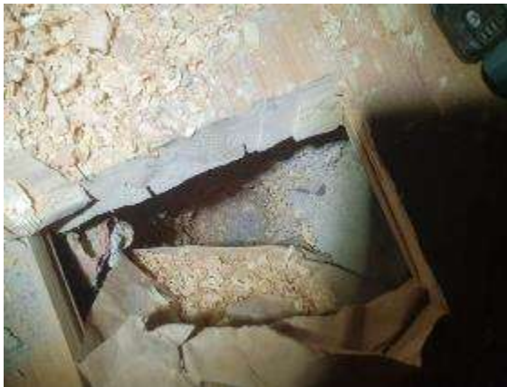
KUVA 109 LIIKUNTASALIN LATTIARAKENTEEN RAKENNEAVAUKSESSA HAVAITTIIN MIKROBIPERÄISTÄ HAJUA JA KUTTERINLASTUT OLIVAT TUMMUNEET ALAOSISTAAN.
