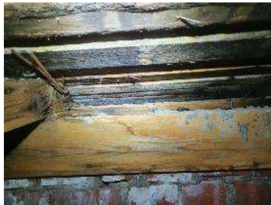
KUVA 99 KATTOKANNAKKEISSA LAHOA VUOTOPAIKAN KOHDALLA.
