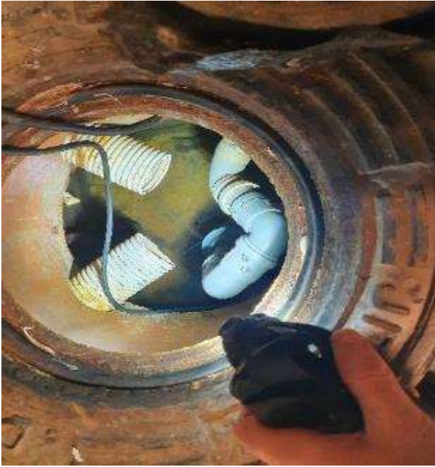
KUVA 74 TEKNISEN TILAN LATTIARAKENNE PIDETÄÄN KUIVANA UPPOPUMPUN JA SIIVILÄKAIVON AVULLA.
