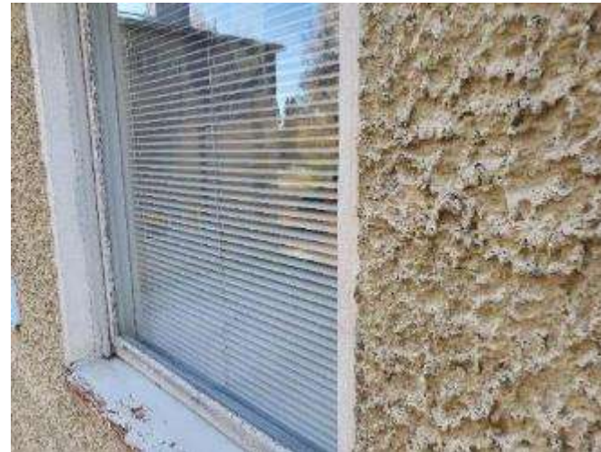
KUVA 42 POHJOISEN PUOLEN IKKUNAT OVAT SÄILYNEET PAREMMASSA KUNNOSSA MITÄ LÄNNEN JA ETELÄN PUOLELLA
