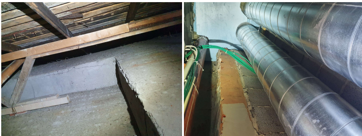
Liikuntasalin ilmanvaihtokanavat betonia Uusitut kanavat kierresaumakanavaa
