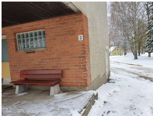
Tiiliverhouksen nurkka rapautunut
