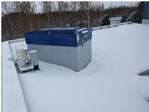
Länsi-päädystä on keittiön ja 1. krs sosiaalitilojen poistoimurit.
