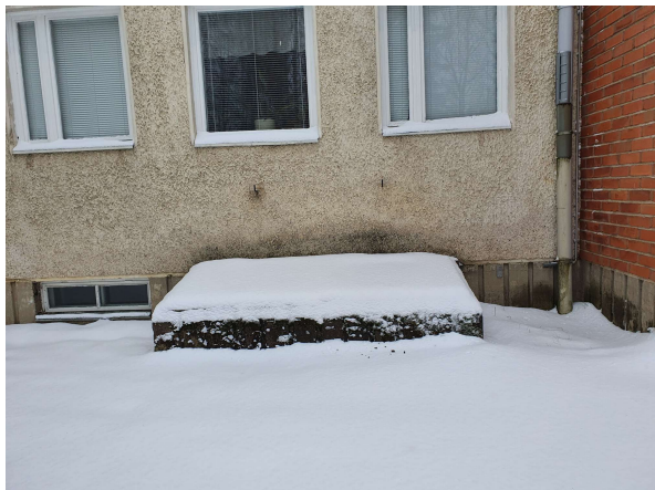
Kellariin johtavasta luukusta roiskunut vettä seinälle
