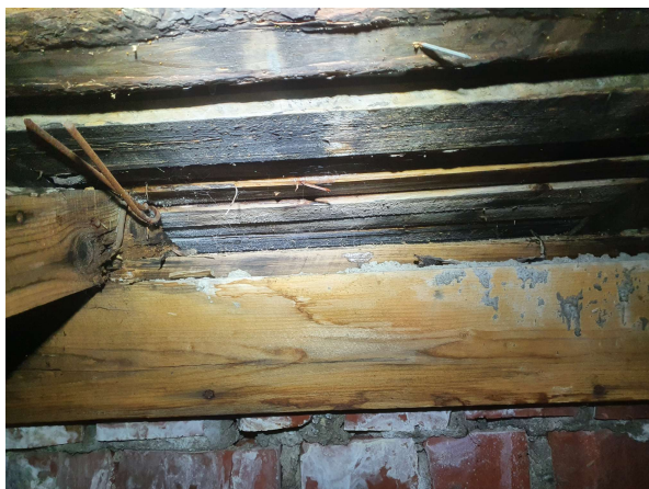
Vuotokohdalla palkissa lahoa
