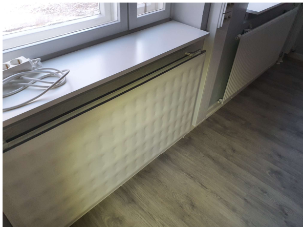
Osin lämmitysverkosto alkuperäistä
