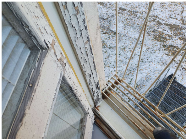
Parvekkeiden ovet ovat huonokuntoisia.
