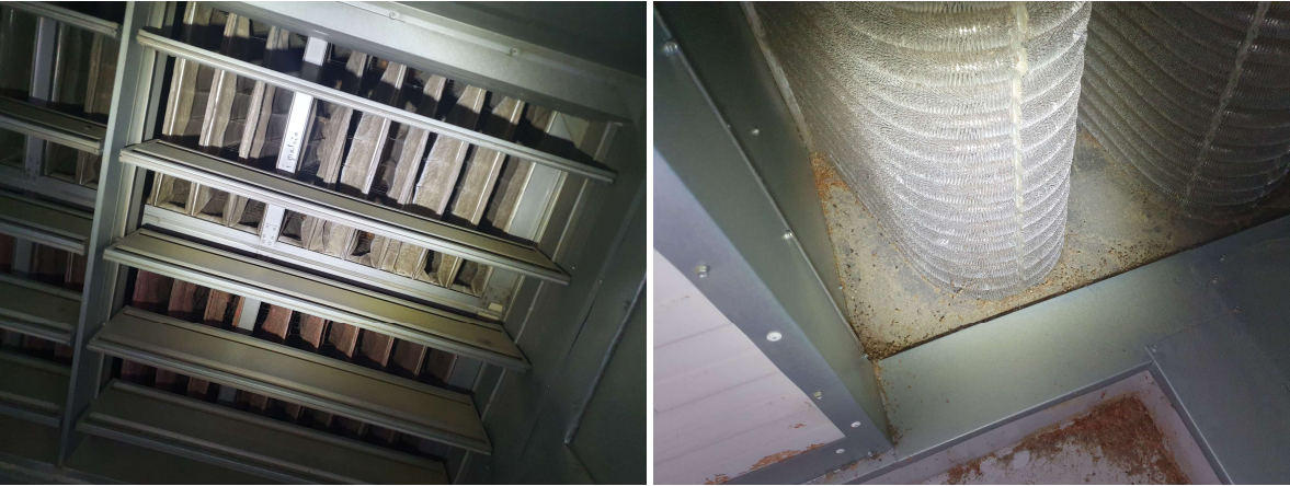
Luokkatilojen iv-koneen suodattimet likaiset Tuloilmakammiossa runsaasti pölyä
