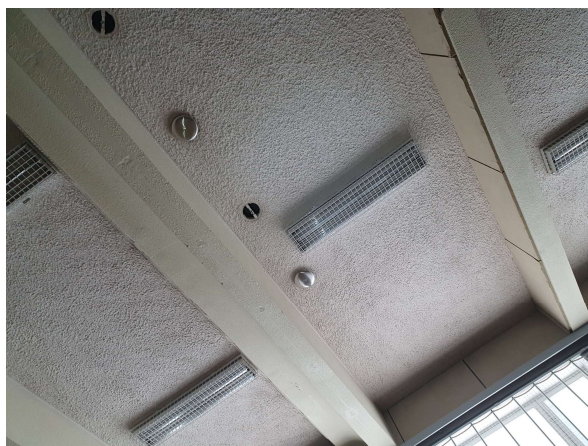
Katon akustiikkalevyjä rikki
