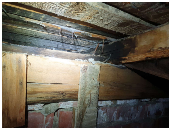
Vuoto porrashuoneen 311 kohdalla, palkissa lahoa
