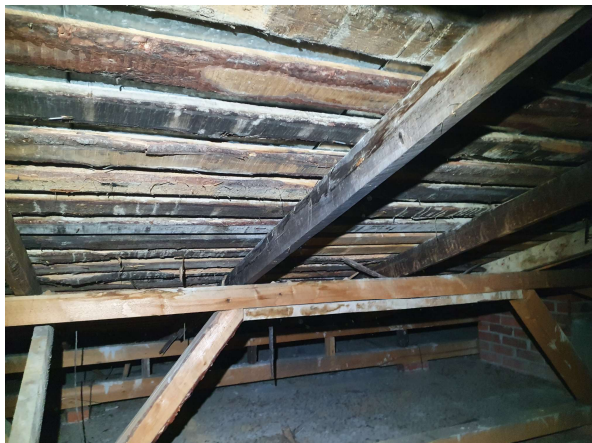
Katerakenteissa vanhoja vuotojälkiä
