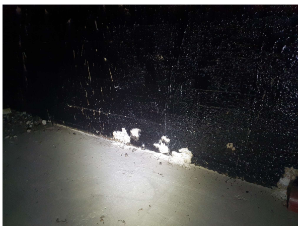
Kellarin seinillä pikisively, joka paikoin hilseillyt. Piessä on PAH-yhdisteitä.
