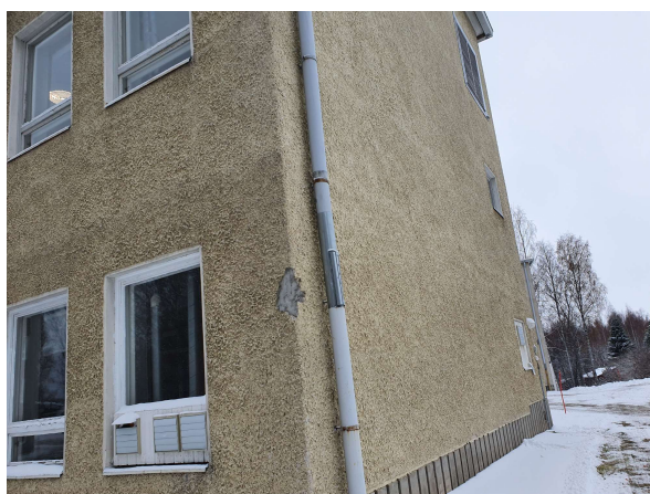
Nurkalta rappaus irti
