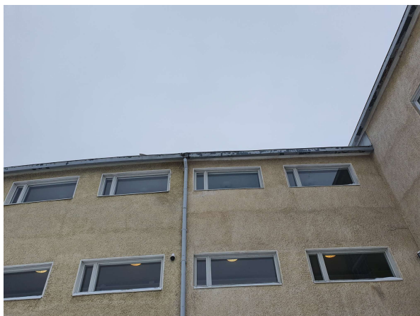
Takasivulla kouru vuotanut ja kastellut seinää
