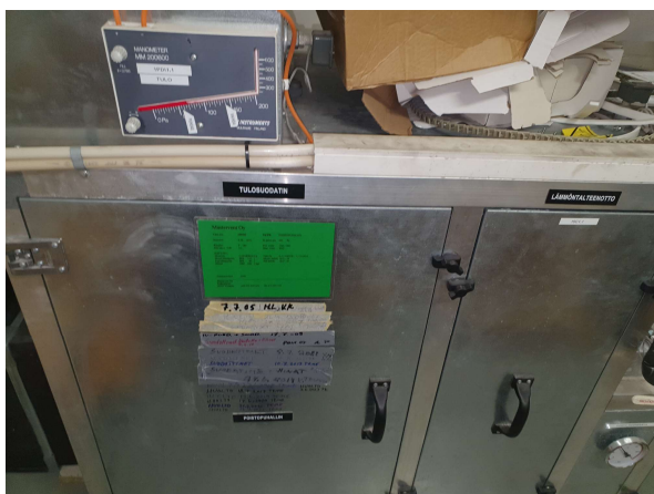
Länsipäädyn kellarissa on tulo-poisto-kone. Päällisin puolin kunnossa.
