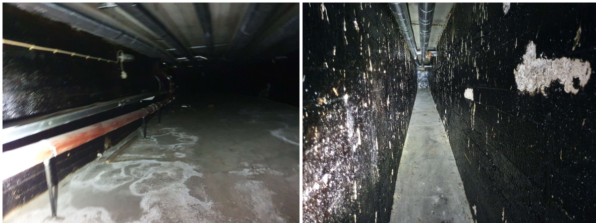
Kaarevalla osalla lattiassa vanhoja vesijälkiä Putkitunneleiden seinästä piki irtoillut
