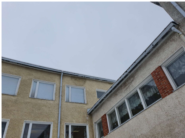
Ulkoseinissä näkyy kolme vesivuodon merkkejä etupihan puolella.
