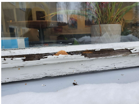
Ikkunoista maalipinta irti, uloimmissa osissa lahoa
