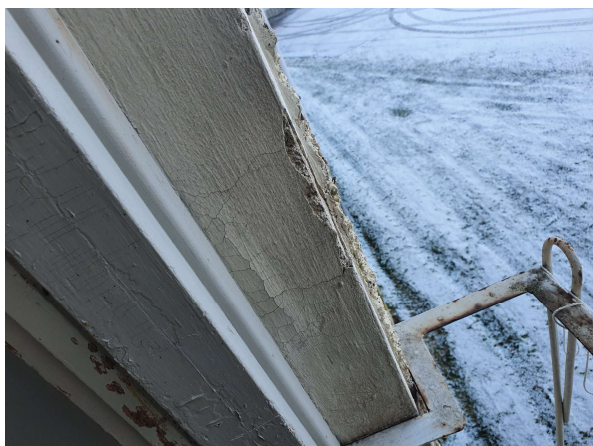
Parvekeovien pielen rappaukset halkeilleet
