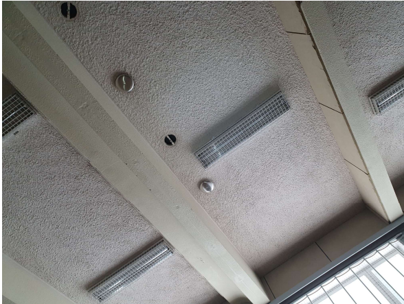
Liikuntasalista puuttuu venttiilejä
