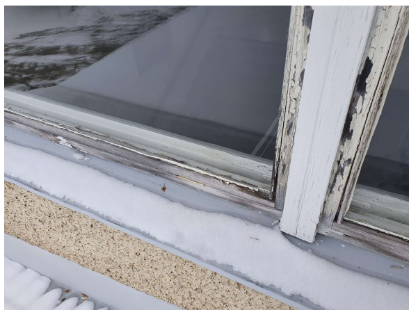
Lasin alapuolelta paikoin listoja irti
