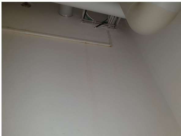
Seinässä veden valumajälkiä
