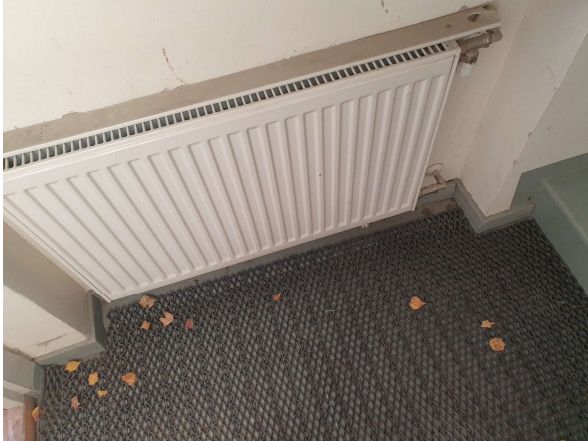
Lämmityspattereita paikoin uusittu
