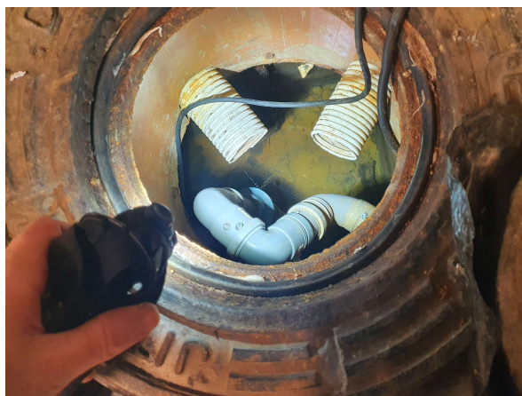
Salaojakaivo teknisen tilan alla
