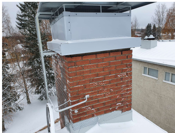
Vanha öljylämmityksen piippu pois käytöstä, piippu suojattu verkolla linnuilta
