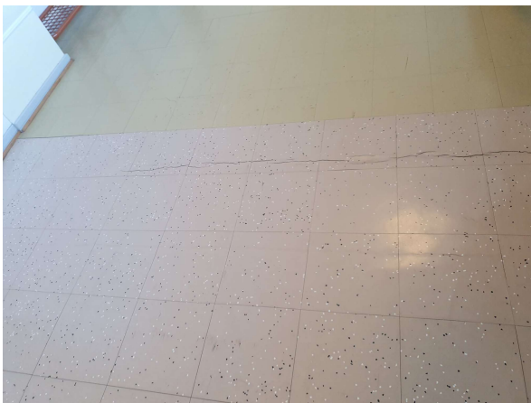
3. kerroksen käytävän lattiassa on murtuma alkuperäisen ja laajennusosan rajapinnassa
