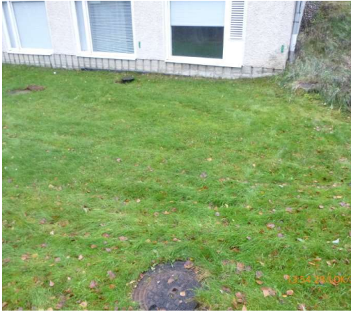
Salaojille on tarkastuskaivoja (vanha kuva)
