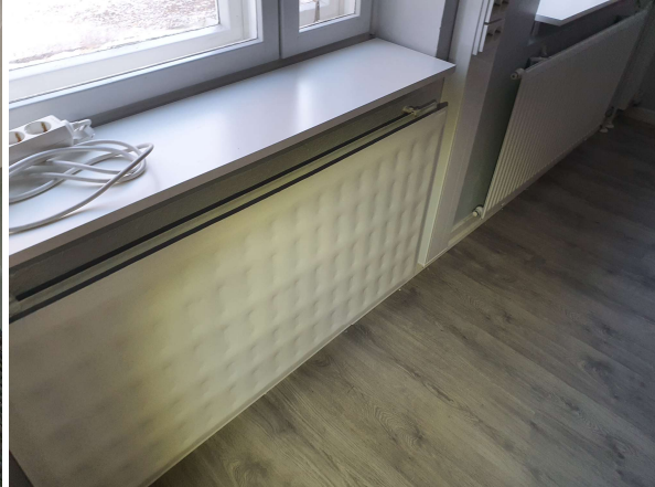
Pääosin lämmityspatterit alkuperäisiä
